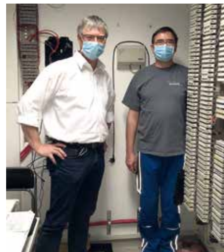
Matthias Schröter, Leiter Technik und Innovation, und Joachim Oetter als zuständiger Elektromeister vorm „historischen“ Telefonverteiler des Krankenhauses Grimma
